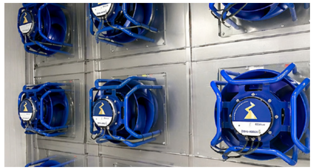
Nueva instalación con unidades modulares eficientes
